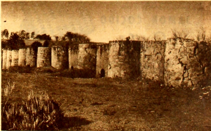
EL TIEMPO HA INICIADO YA SU ACCION DESTRUCTORA, DETERMINANDO RAJADURAS EN LA ESTRUCTURA DE LOS PILARES
