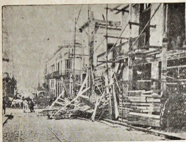
La casa de la calle Treinta y Tres, momentos después de producirse el derrumbe
